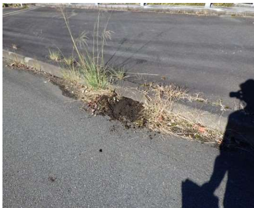
写真-2.3 排水ますの土砂詰り
