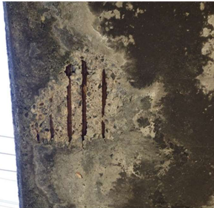
写真-2.1 橋脚の剥離・鉄筋露出
