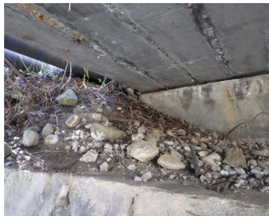
写真-2.4 支承部の土砂詰り
