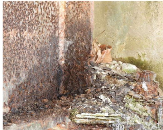
写真-2.2 鋼桁・支承の腐食、防食機能の劣化
