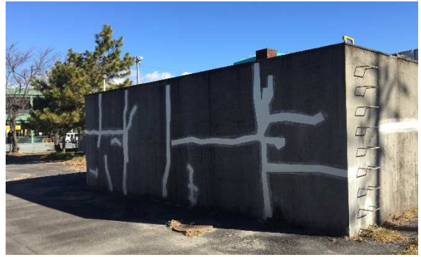
リバーサイド配水場
