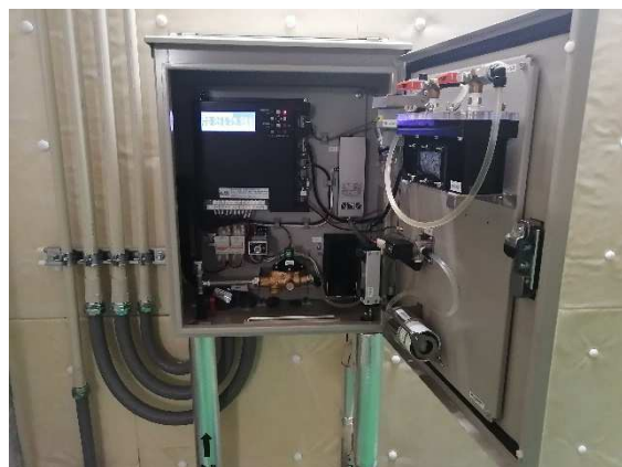
水質監視装置（布施配水場）
