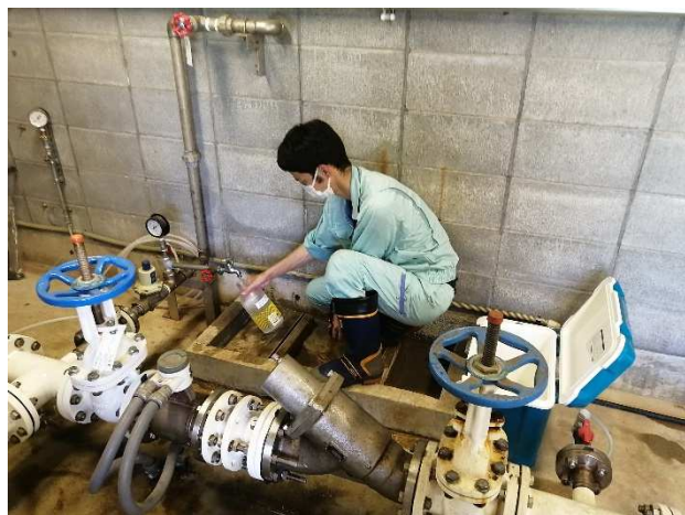
深井戸水源における水質検査（簡易水道事業 第9水源）
