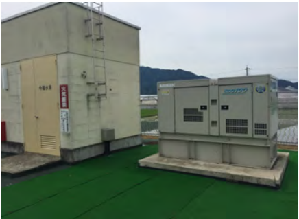
【今福水源と非常用発電機】
