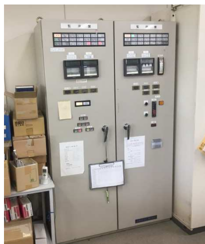
【中央監視盤（豊富庁舎内）】
