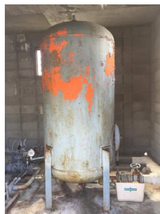
【圧力タンク（鍛冶新居配水場）】
