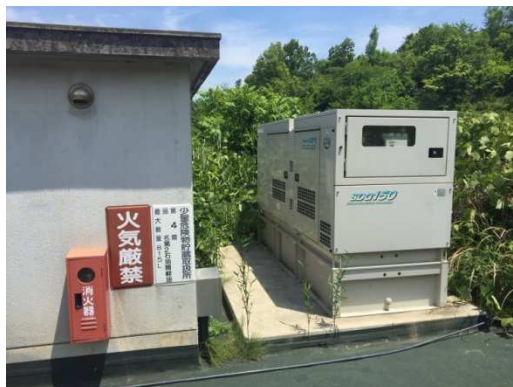
【非常用発電機（第9水源）】
