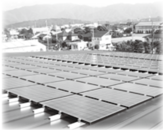
玉穂総合会館屋上に設置された太陽光発電パネル
