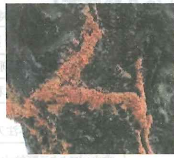
蟻道 (蟻が移動するトンネル)
