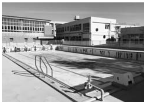
側面がテープで補修されている三村小学校プール
