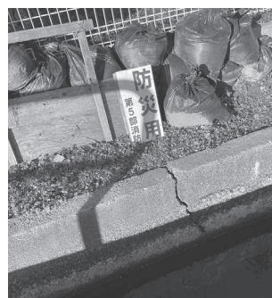
ひびの入った用排水路
