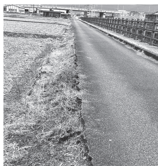
擁壁がなく舗装が崩れている
