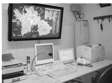
田富庁舎内デジタル防災無線機
