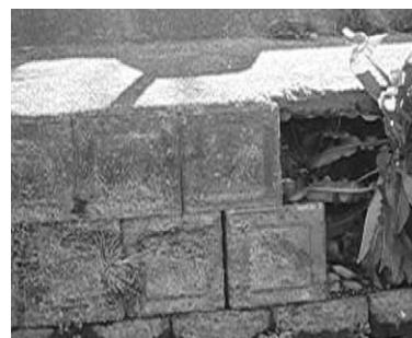
宇坪川の側壁の崩落箇所
