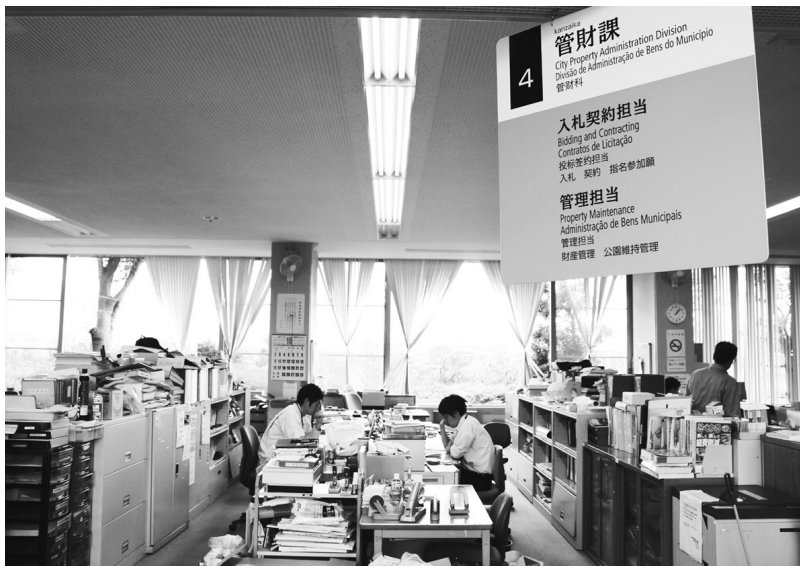
市役所管財課に設置されているLED照明
