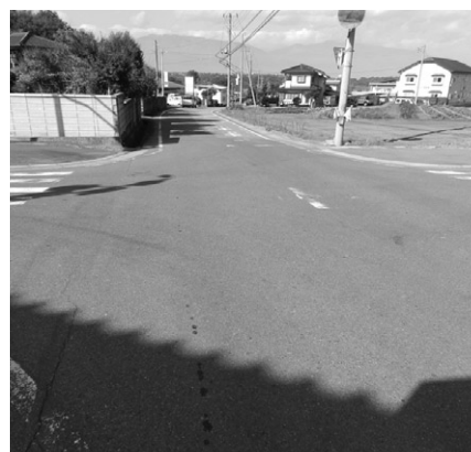
路面標示補修前（関原地区交差点）
