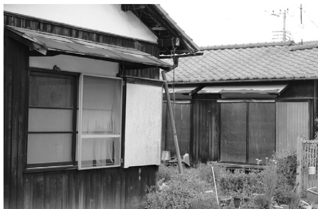
老朽化が進む飛石住宅
