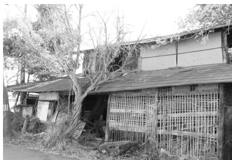
危険な空き家
