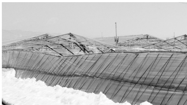
大雪により倒壊したビニールハウス(藤巻地区)
