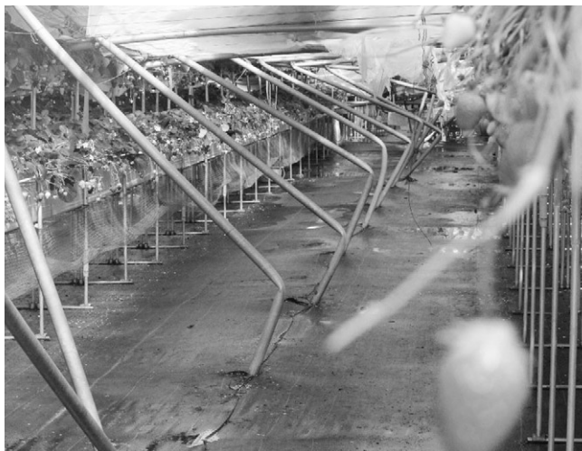
雪の重みで押し潰されたビニールハウス(成島地区)
