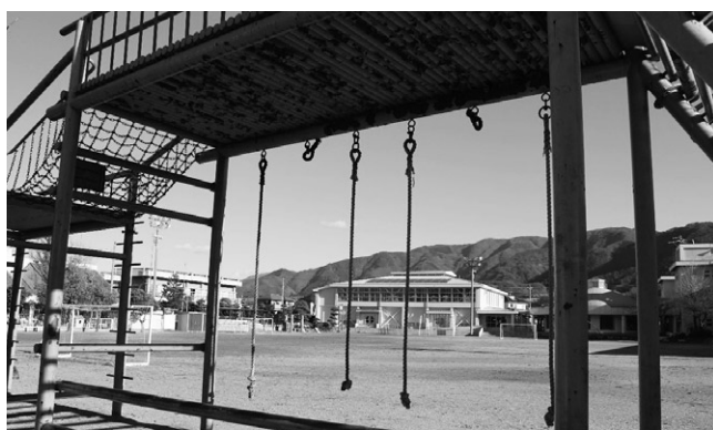
経年劣化により修繕する遊具（豊富小）
