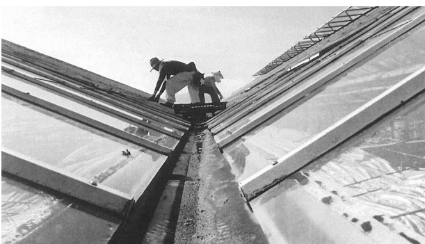
雪害の被害を受け再建中のハウス
