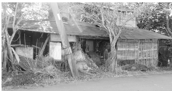
老朽化が進む空家
