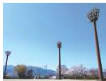
改修予定の玉穂ふるさとふれあい広場の照明設備
